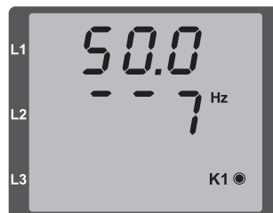
Ejemplo 1: Fig. Indicación de la frecuencia de la red (50,0 Hz) y del sentido del campo giratorio.
